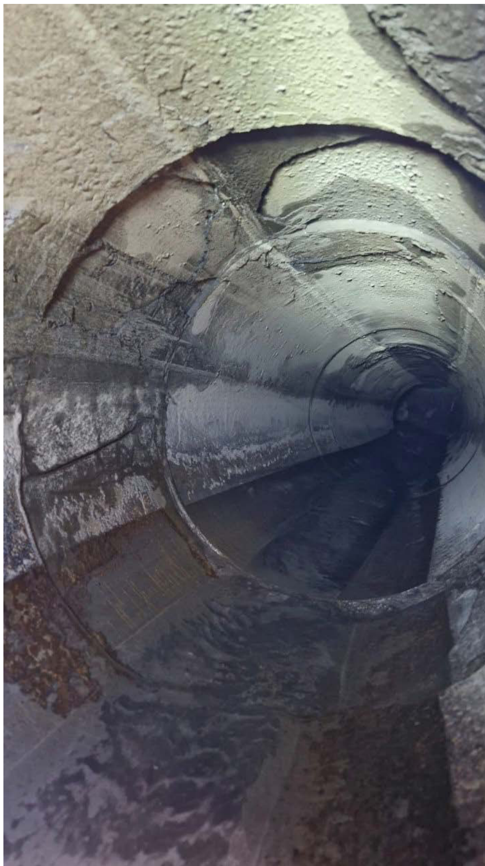
Рисунок 4.26 - Внутренняя поверхность опытно-промышленного участка пульпопровода ГЗУ Хабаровской ТЭЦ-3
