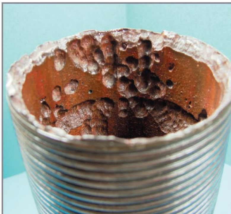
Рис. 3.1. Коррозионное повреждение НКТ из углеродистой стали, вызванное углекислотной коррозией [56]
