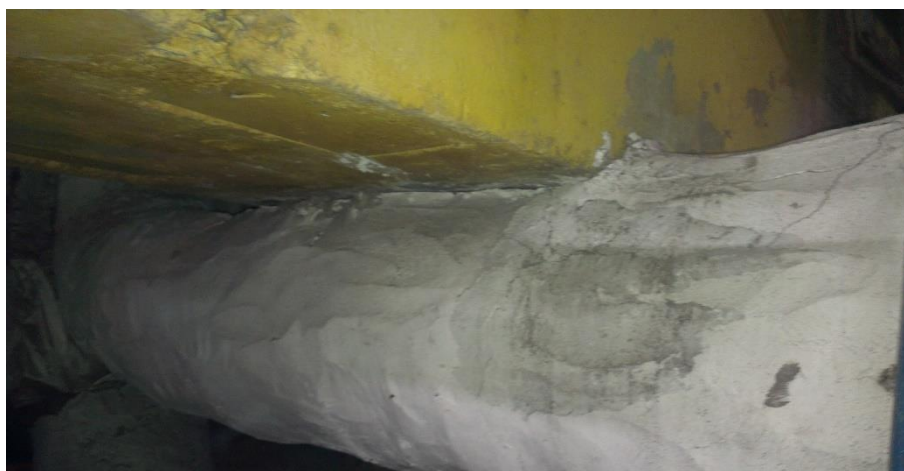
Рисунок 3.11 - Отсутствие зазора между изоляцией трубопровода и фундаментом турбоагрегата ПТ-50-130/7 ТМЗ ст.№ 12 АО «Ново-Кемеровская ТЭЦ»
