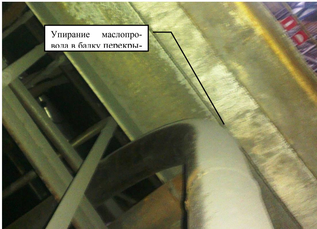
Рисунок 3.29 - Упира́ние маслопровода в балку перекры́тия (вид снизу)
